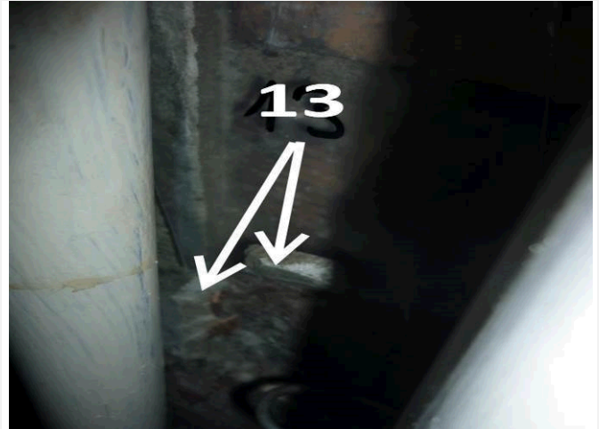
Composant : Peinture ou enduit 13 (N) enduit gris mural derrière chaudière Cellule 10
