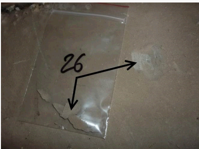
Composant : Ragréage 26 (N) brun sous parquet flottant Cellule 2
