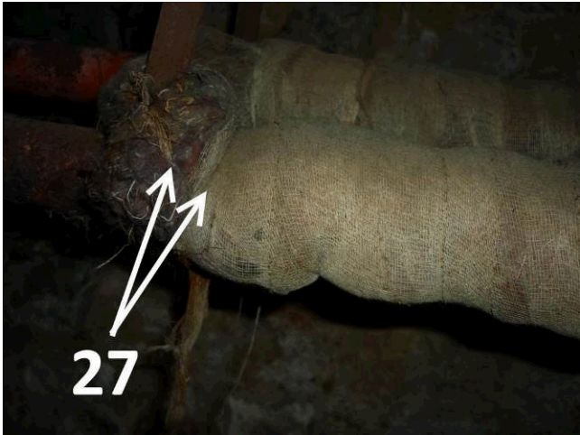
Composant : Calorifugeage 27 (N) calorifuge fibreux + enveloppe fibre beige Cellule 20
