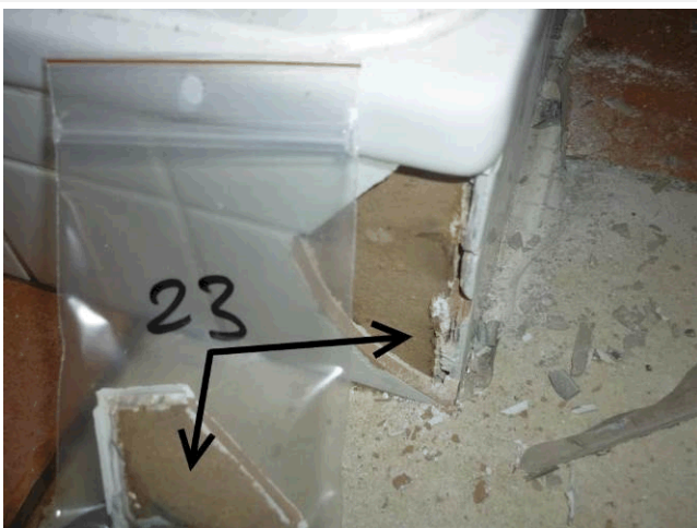
Composant : Colle des carrelages 23 (N) colle blanche sous faïence 10x10cm blanche + joint blanc (tablier bac à douche) Cellule 8
