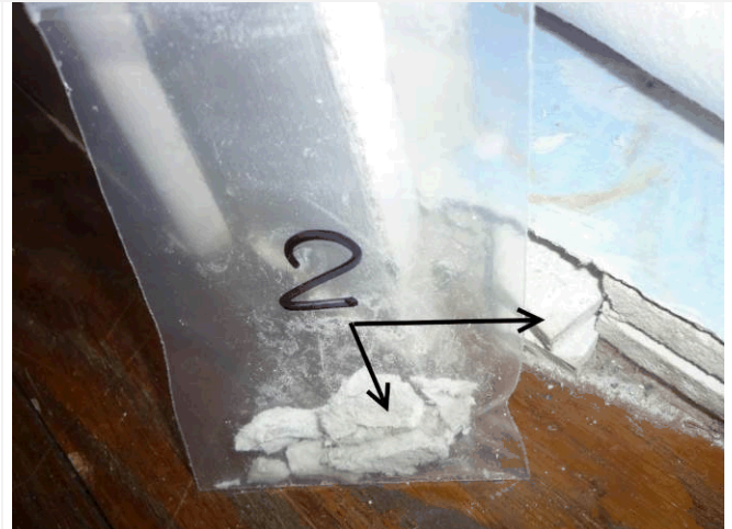
Composant : Panneaux rigides (cloisons, gaines, plafonds) 2 (N) gris fibreux au sol Cellule 16, sur plancher bois, sous lé PVC
